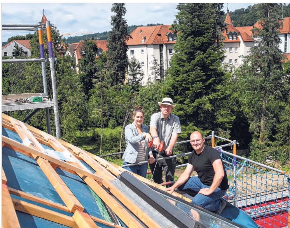
„Deutsches Reihenhaus“-Kundenbetreuerin Laura Götz, Baubürgermeister Julius Mihm und Bauleiter Florian Zöbelein (von links) auf dem Dach des hinteren Reihenhauses Richtung Buchstraße. (Foto: Tom)
