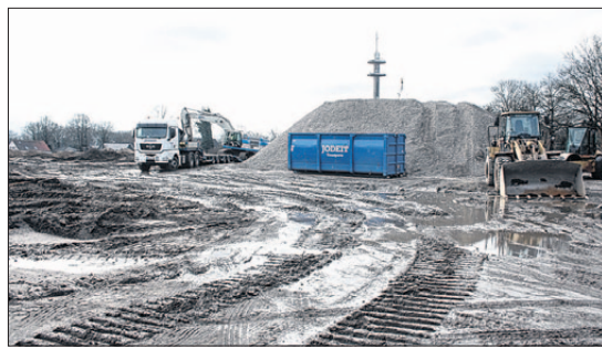
Dieser Haufen, der annähernd hundert Meter lang ist, ist früher die Paracelsus-Klinik gewesen. Das Material wird wiederverwertet. Fotos: Spreer
