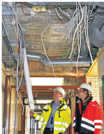
Bauingenieur Thomas Kölsch (links) und Bauleiter Daniel John schauen sich die von Einbrechern und Dieben angerichteten Schäden an. Unter anderem wurden Tausende Meter Kupferkabel aus Decken und Wänden gerissen und abgeschnitten. MICHAEL ZWICKER (4)
