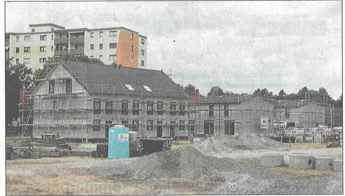
Abgeschirmt: Hinter den Lärmschutzwänden entlang der Vélizy- und der Offenbacher Straße wächst die Reihenhaussiedlung rasch. Auch die ersten Garagen werden schon angeliefert. ■ Foto: nkö
