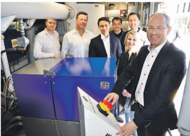
Mit einem Knopfdruck startete Bürgermeister Benedikt Bisping den Motor des Blockheizkraftwerks, das zentral alle Häuser mit Strom und Wärme versorgt.
