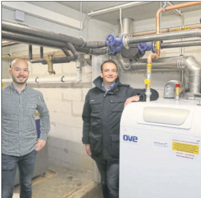
In der Technikzentrale: Lars Lambrecht (links) von der Deutschen Reihenhaushaus AG und Alexander Grafe von der Firma OVE, die das Blockheizkraftwerk für den Wohnpark „Am Jungfernkopf“ betreibt.
