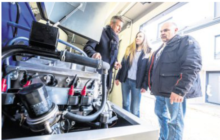
Bauleiter Michael Strohm und Vertrieblerin Patrizia Georgiadis erklären Bürgermeister Tesche die Heiztechnik im Neubaugebiet an der Düppelstraße. –FOTO: GUTZEIT
